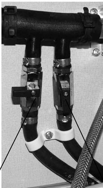
Kran för bakre golvvärme-slinga. Visas i stängt läge.
