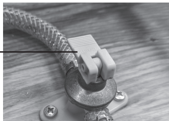
Avtappningskran varmvattenberedare (i stängt läge)
