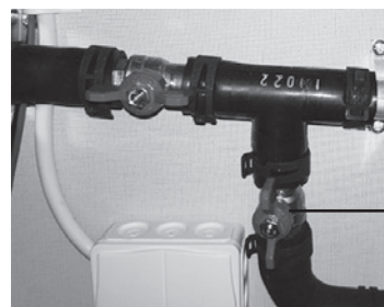
Shuntventil golvvärme i öppet läge
