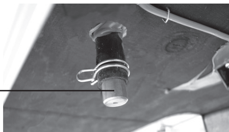
Avtappningsplugg vid ytterdörr/under panna
