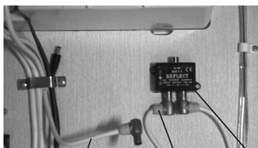
Från kabel-TV ingång Till fördelningsdosan Antennförstärkare
