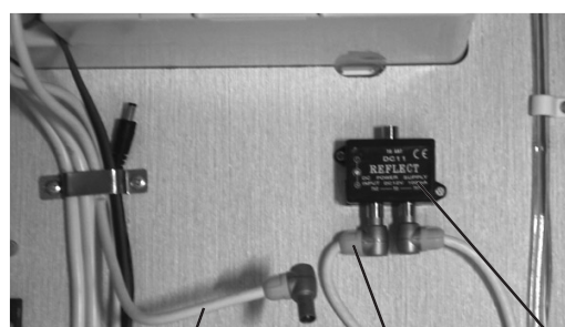
Från kabel-TV ingång Till fördelningsdosa Antennförstärkare
