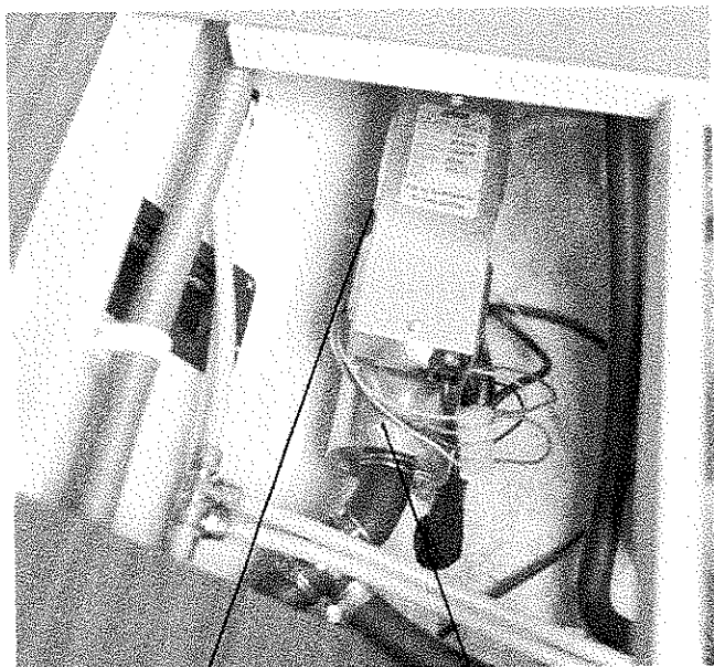
Knapp för återställning
