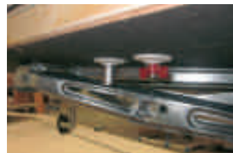
Gråvattentankens utvändiga avloppskran
