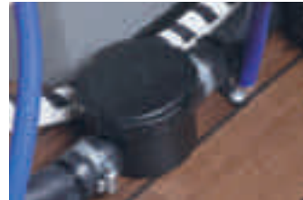
Vattenlåset till gråvattentanken
