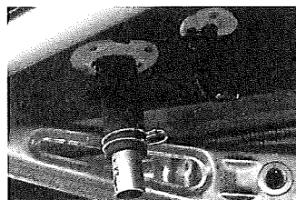
Gråvattentankens utvändiga avloppskran
