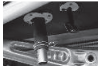
Gråvattentankens utvändiga avloppskran
