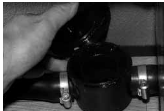
Vattenlåset till gråvattentanken
