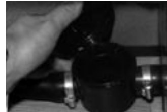
Vattenlåset till gråvattentanken
